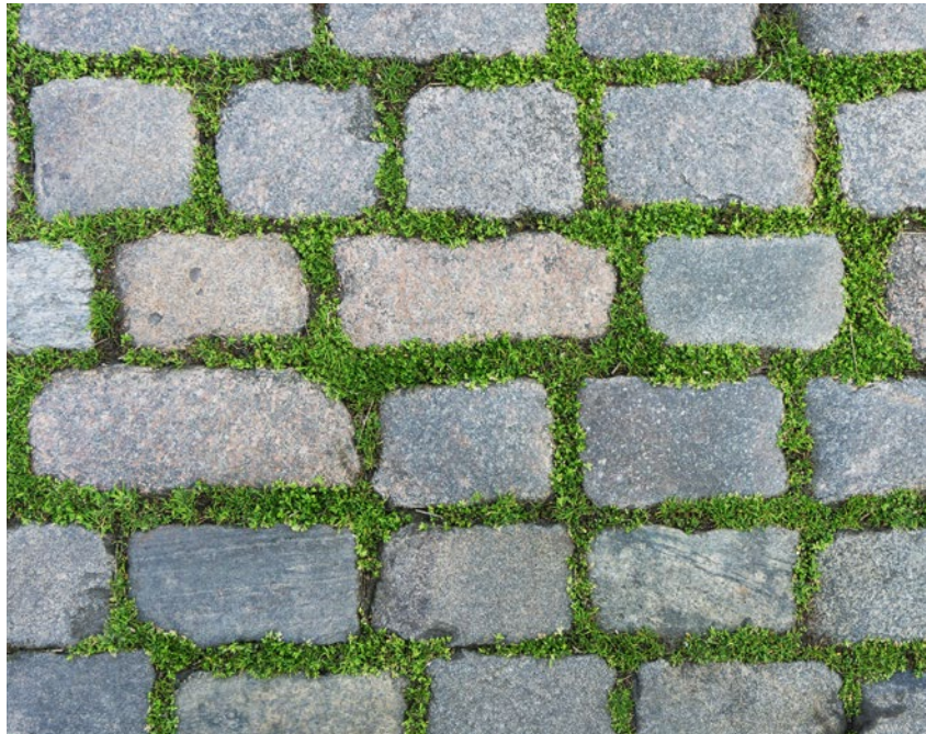
Natursteinpflaster mit Bewuchs
