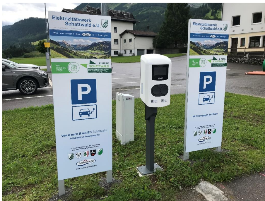
Bild 16: E-Ladesäulen (Quelle: Gemeinde Schattwald)
