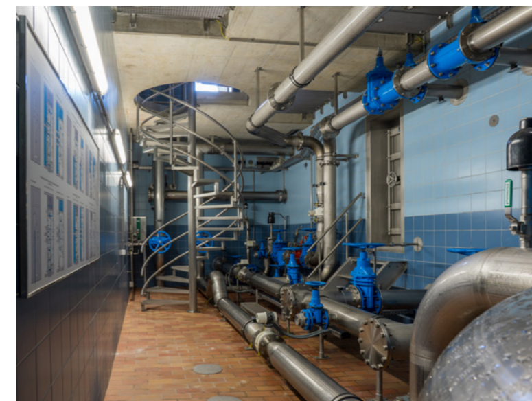
Die Verrohrung im Wasserbehälter Schottleiten (Rum) im Untergeschoss. Ersichtlich ist auch die Zugangstür zur Wasserkammer 1, die erst nach dem Ablassen des Wassers zu Wartungs- und Reinigungszwecken geöffnet werden kann. © Markus Jenewein
