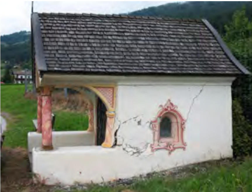
Tulfes, Huisenkapelle, Außenansicht nach Auffahrnfall 2009 | Foto: Rampold
