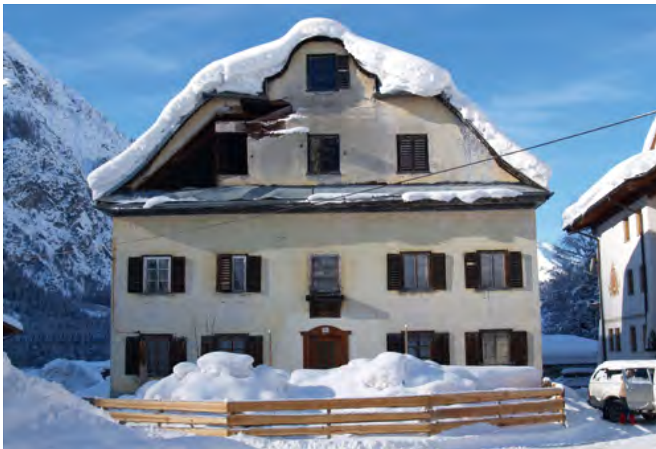
Holzgau, Holzgau 42, Ansicht gegen Westen mit schadensfördernd herbeigeführtem Verfall von Fassade und Dachwerk | Foto: Hauser
