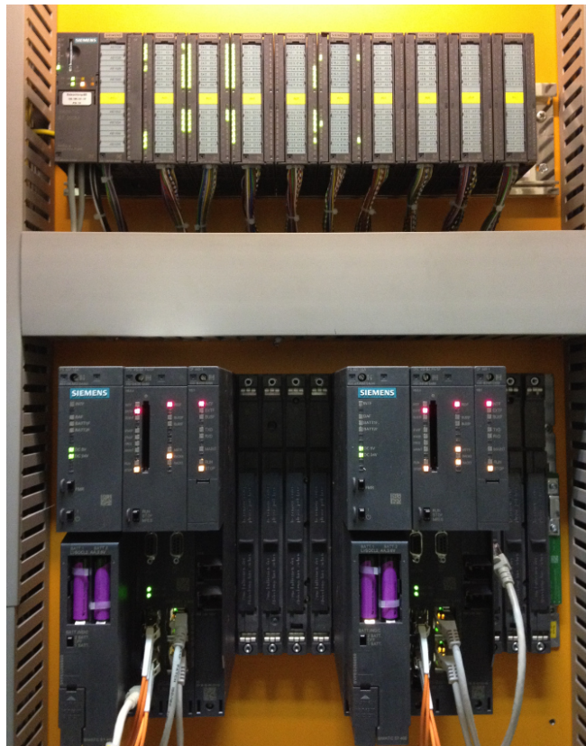
„Nassereith Teile der Steuerung“
