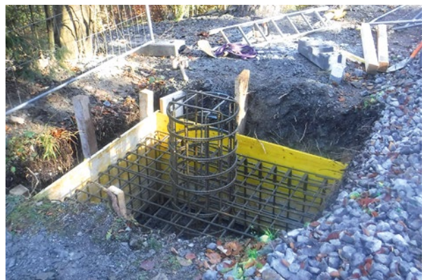
Abb. 3-12: Mastfundament Linie 6. Quelle: IVB/Thöni
