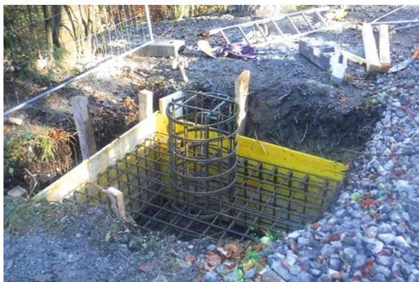
Abb. 3-12: Mastfundament Linie 6. Quelle: IVB/Thöni
