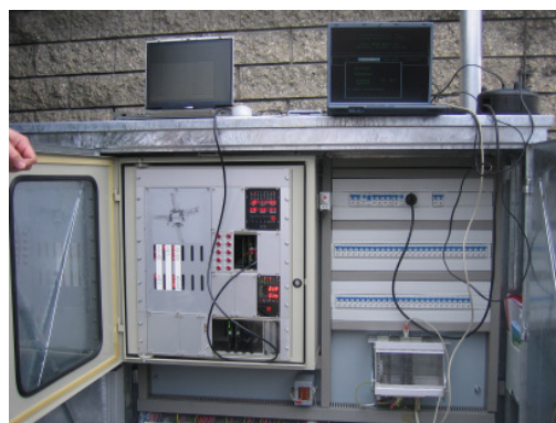
Abb. 7: VLSA-Steuergerät an der Barbarabrücke in Schwaz
